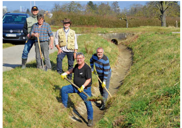
Mit Schaufel und Spaten säubern die vier Fischereivereinsmitglieder Wilfried Hochuli und Winfried Kraut (von links) mit Andreas Schuster sowie Axel Schampera und Eugen Herzog die verschlammten und zugewachsenen Zulaufe zum Annungsee
