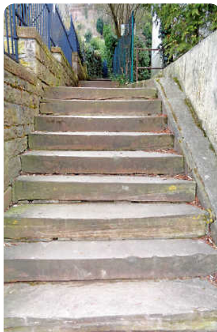
Die Treppenstufen zum Turmberg sind in schlechtem Zustand.
